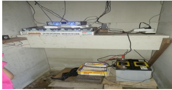
Gambar 11 Bagian Ruangan Alat Speaker Suara Pemanggil Burung Walet
